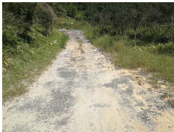
图 7-2 1 标段施工便道尚未实施迹地恢复
