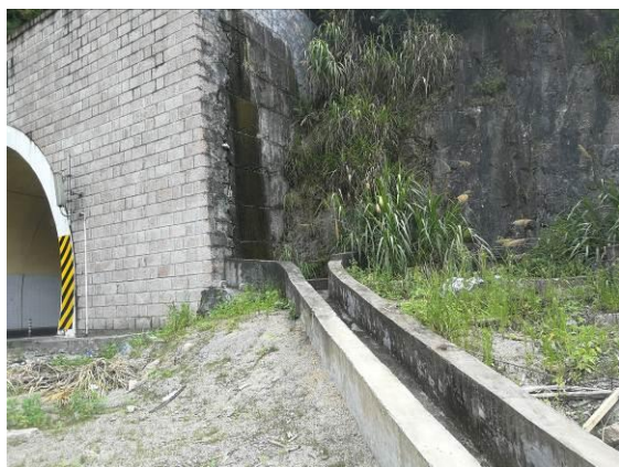
插图 9 十八尖隧道出口截水沟
