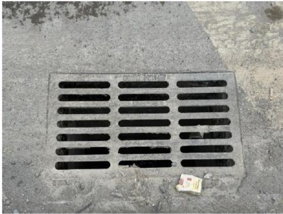
图 1-15 樟山西路雨水口
