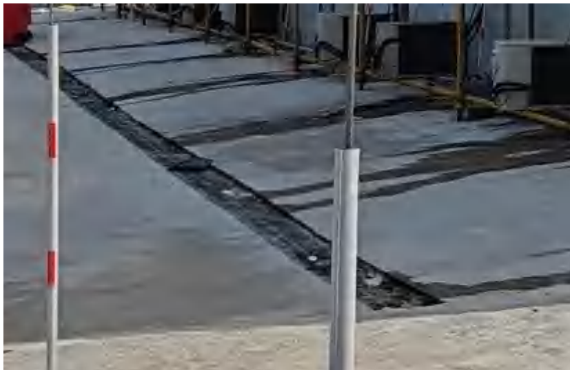
图 17 生活生产区排水沟（2026.9）
